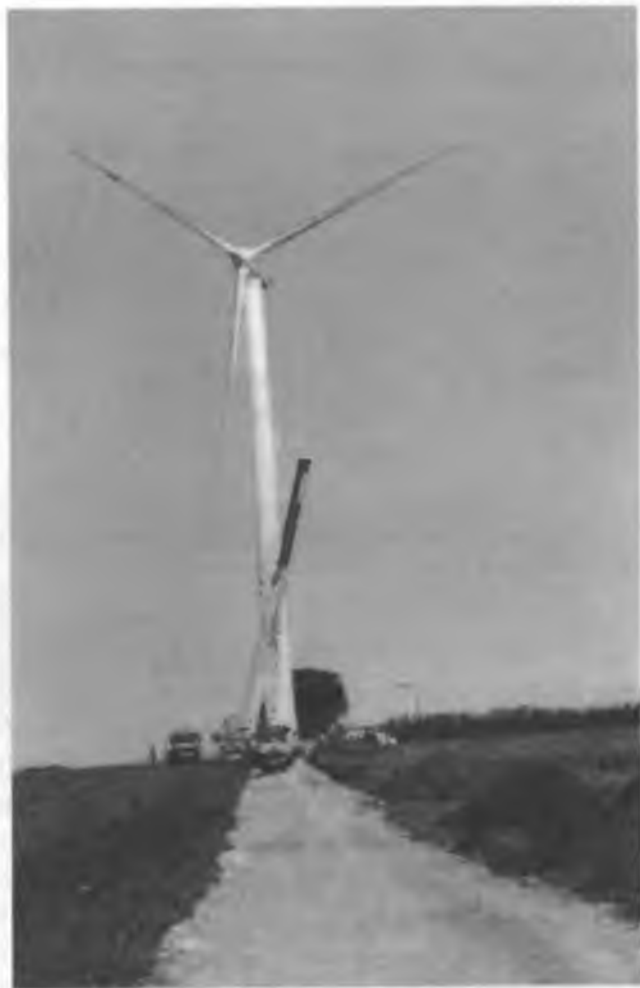
Рис. 12. Его мощность 670 кВт. Он будет производить электроэнергию на 130 тыс. долларов в год
